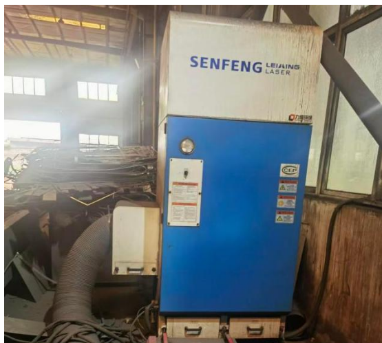
切割滤筒出除尘器
