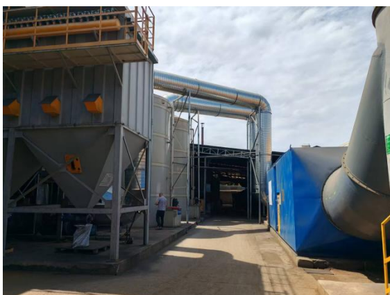
炼胶硫化过程中环保设备（脉冲除尘器+喷淋塔+二级活性炭）
