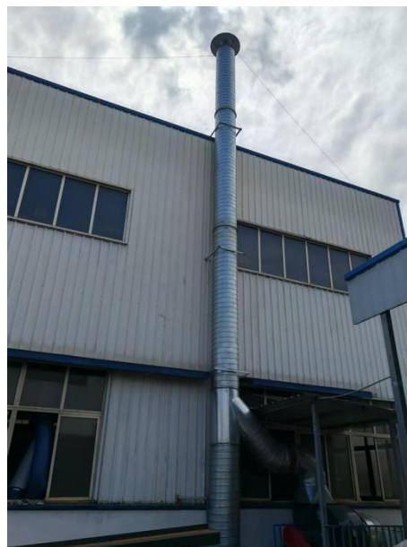
焊烟排气筒 DA004
