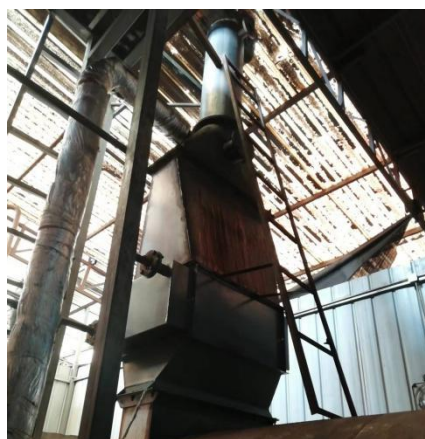
锅炉排气筒 DA003
