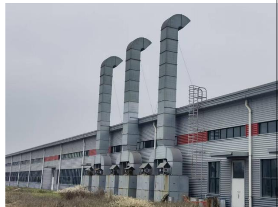
点补室废气处理设施
