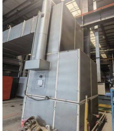
小件喷漆房废气处置装置
