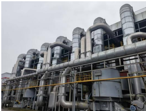
涂装车间 RTO 处理装置
